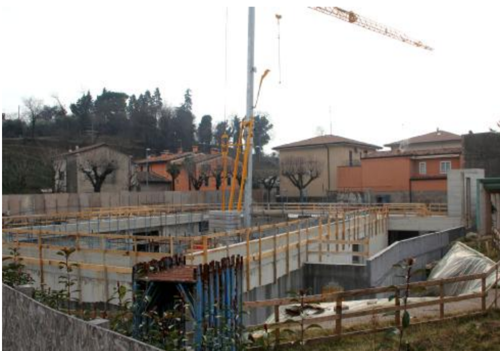
Un cantiere edile a Calmasino: previsti interventi nella frazione e anche a Cisano
